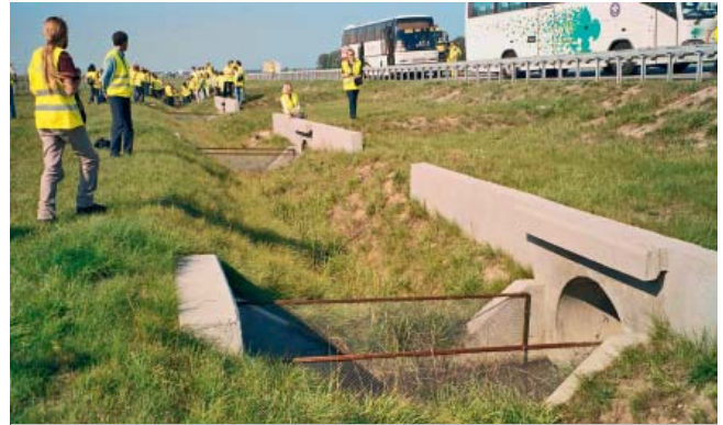
Fot. 1. Przykład przejścia dla małych zwierząt pod autostradą z zastosowaniem osłonowych rur betonowych (autostrada A2, fot. A. Wysokowski)
